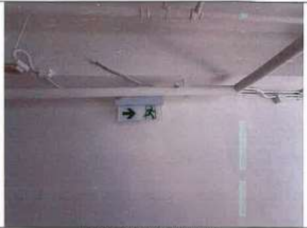
照明（逃生方向燈牌）
