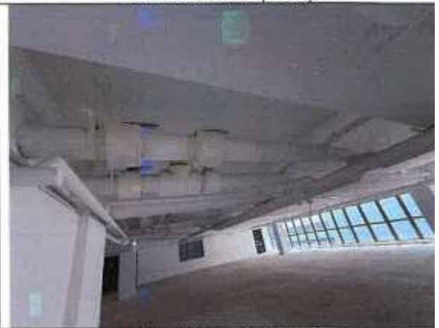
冷凍來回水供應水管
